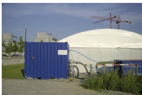
Vandbehandlingsanlæg 10' container samt 20' sedimentationscontainer.
